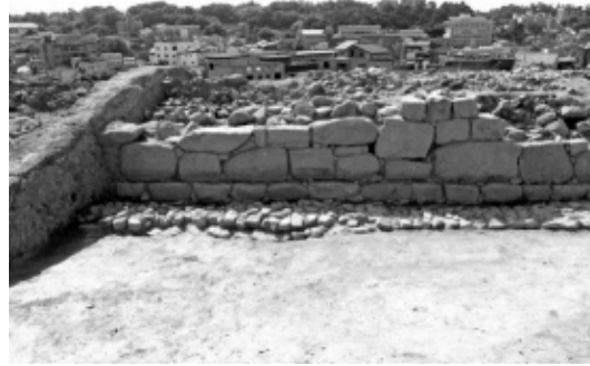
〈그림 10〉 남동벽 구간 외벽 상태
