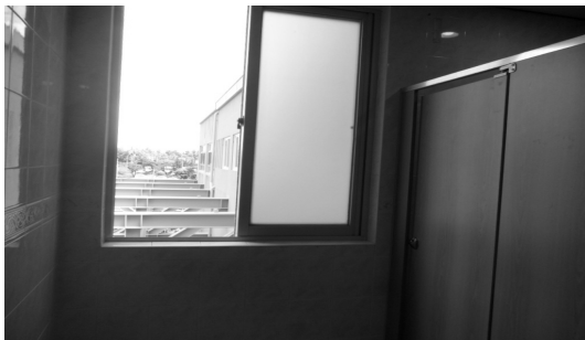
화장실 안전망 미설치
